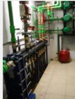
Colector en sala técnica
