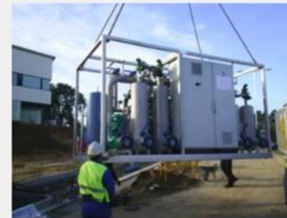
Descarga del HPS (Heat Pump Skid)
