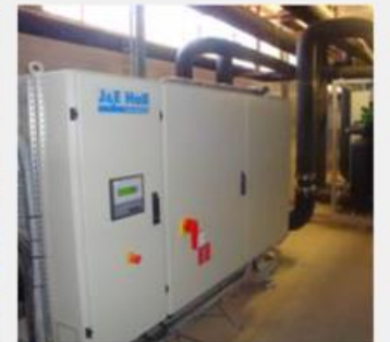
Bomba de calor y instalación geotérmica
