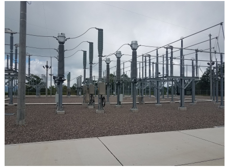
(b) Subestación Chinchayote.
