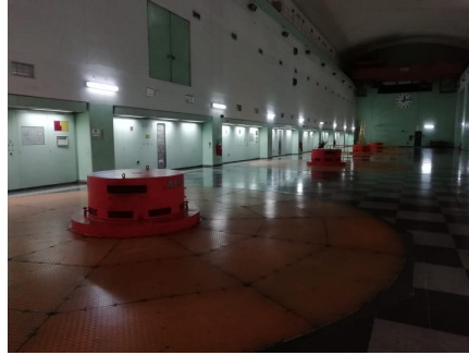
Figura 23: Turbinas de la Hidroeléctrica Francisco Morazán
