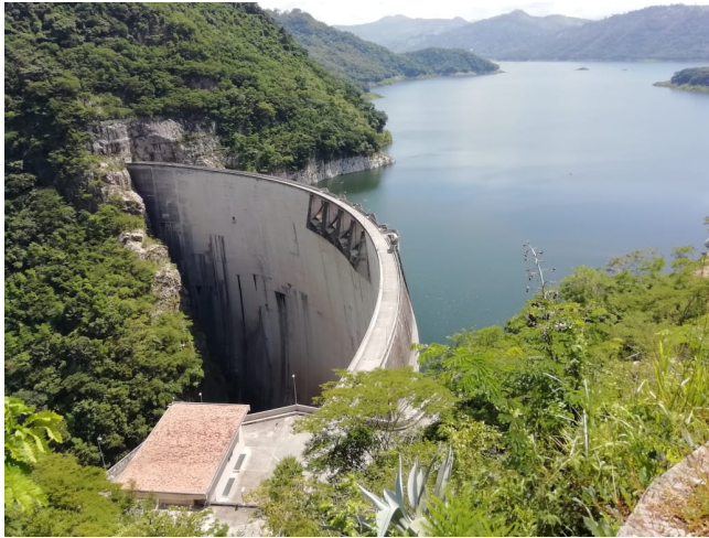
Figura 1: Vista del embalse de la Represa Hidroeléctrica Francisco Morazán. Fuente: Cuadro de Ficha Técnica ENEE
